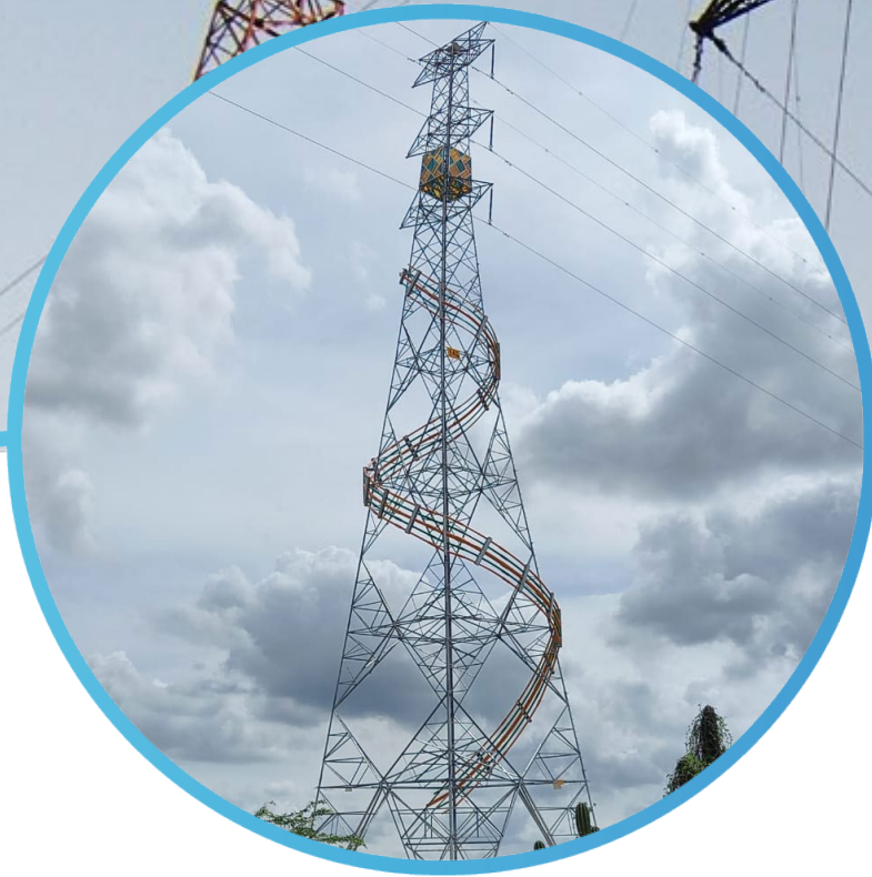
Diseño estructural torre estética : Línea de transmisión Riohacha – Cuestecitas, Riohacha – Maicao a 110kV. (Colombia) Cliente: CONSORCIO CDEM
